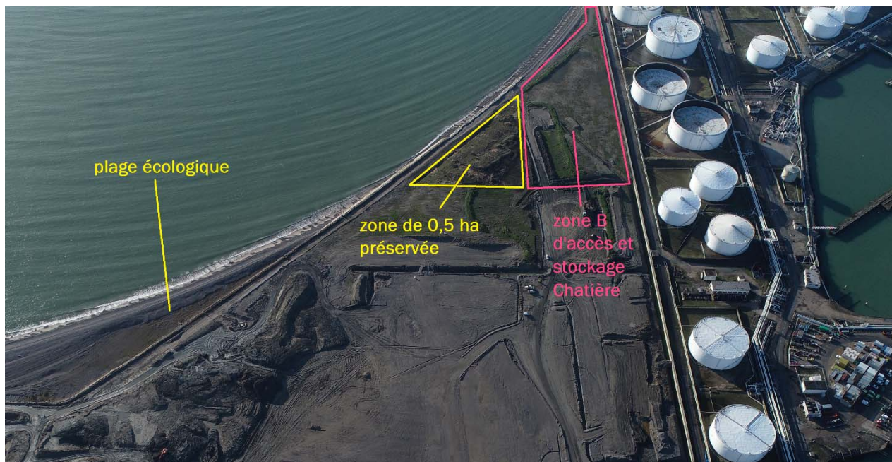
Figure 81 : Travaux en cours en Mai 2021 sur la « zone B » (photo : SBF – EUCLYD)
